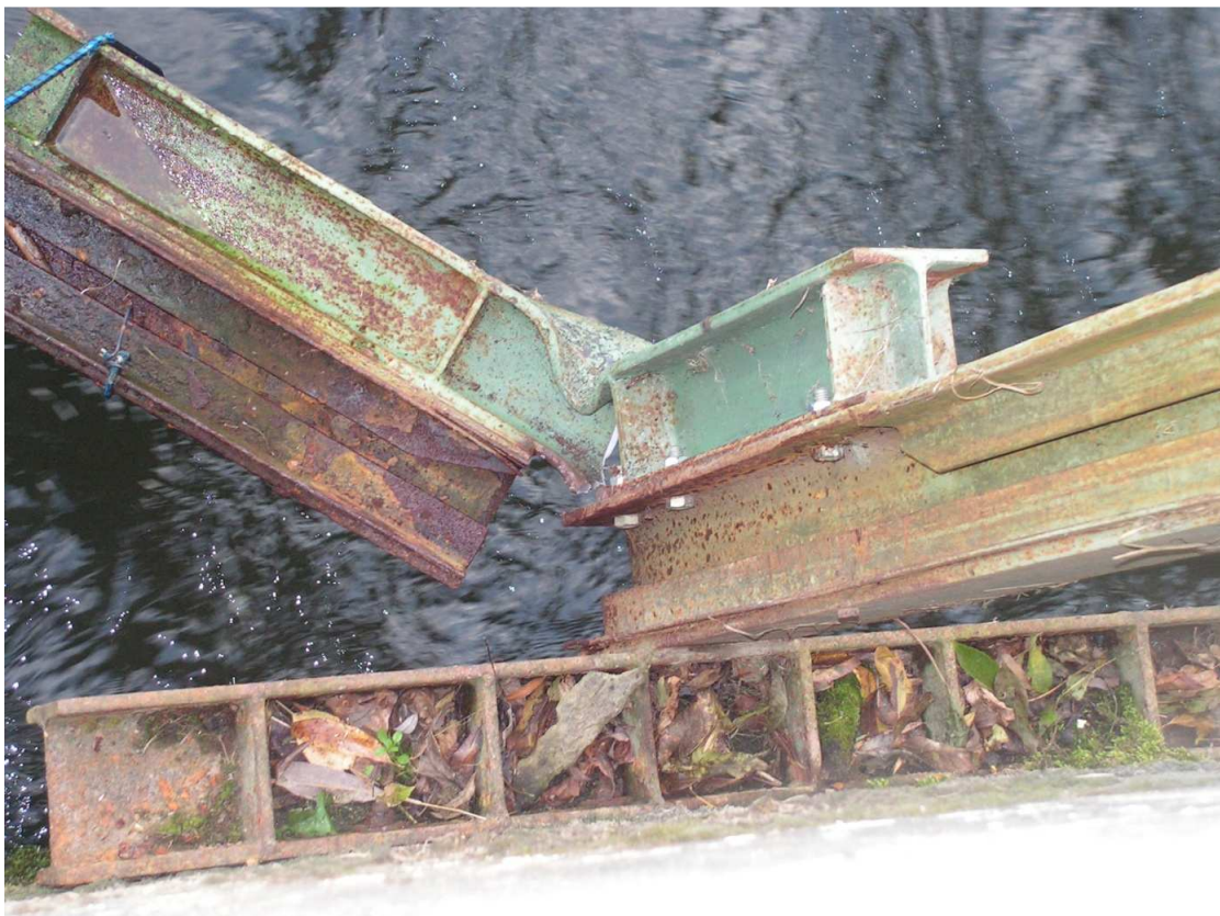
Foto 59: gebrochener Träger der Hamenbefestigung
