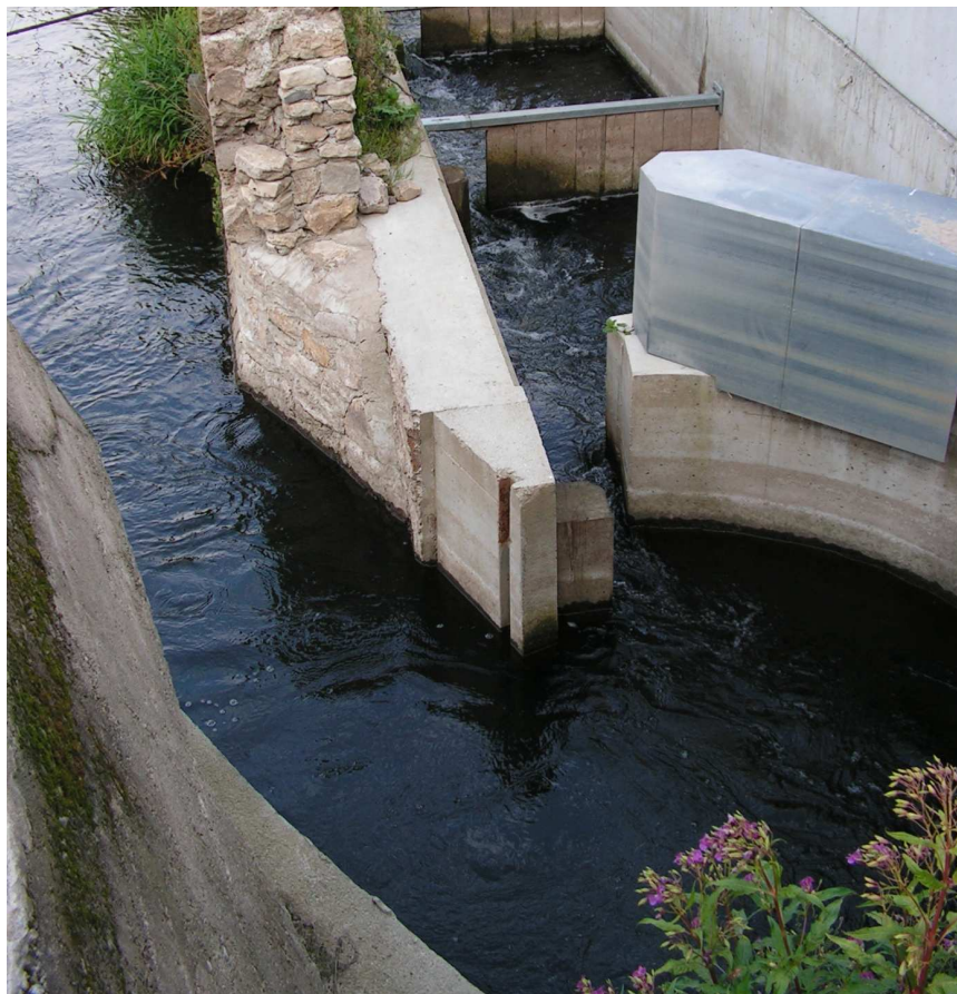
Foto 15: Auslauf des Schlitzpass in den Turbinenkanal
