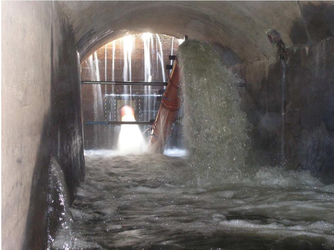
Foto 26: beide Bypassöffnungen in Betrieb
