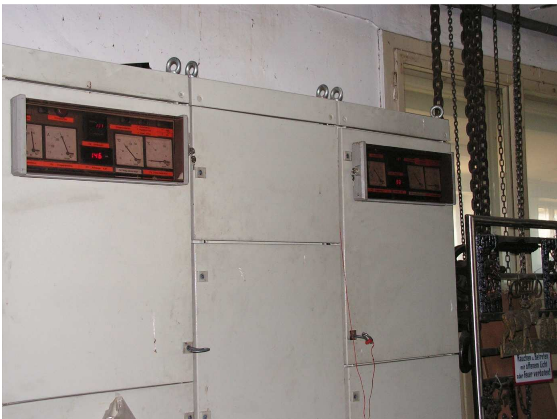
Foto 43: Schaltschrank in der WKA Döbritschen
