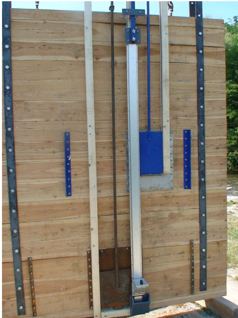
Foto 22: Die Öffnungen des Bypasssystems können separat mit Schiebern verschlossen werden. Zu sehen ist auch die Befestigungsschiene für dieameratechnik.
