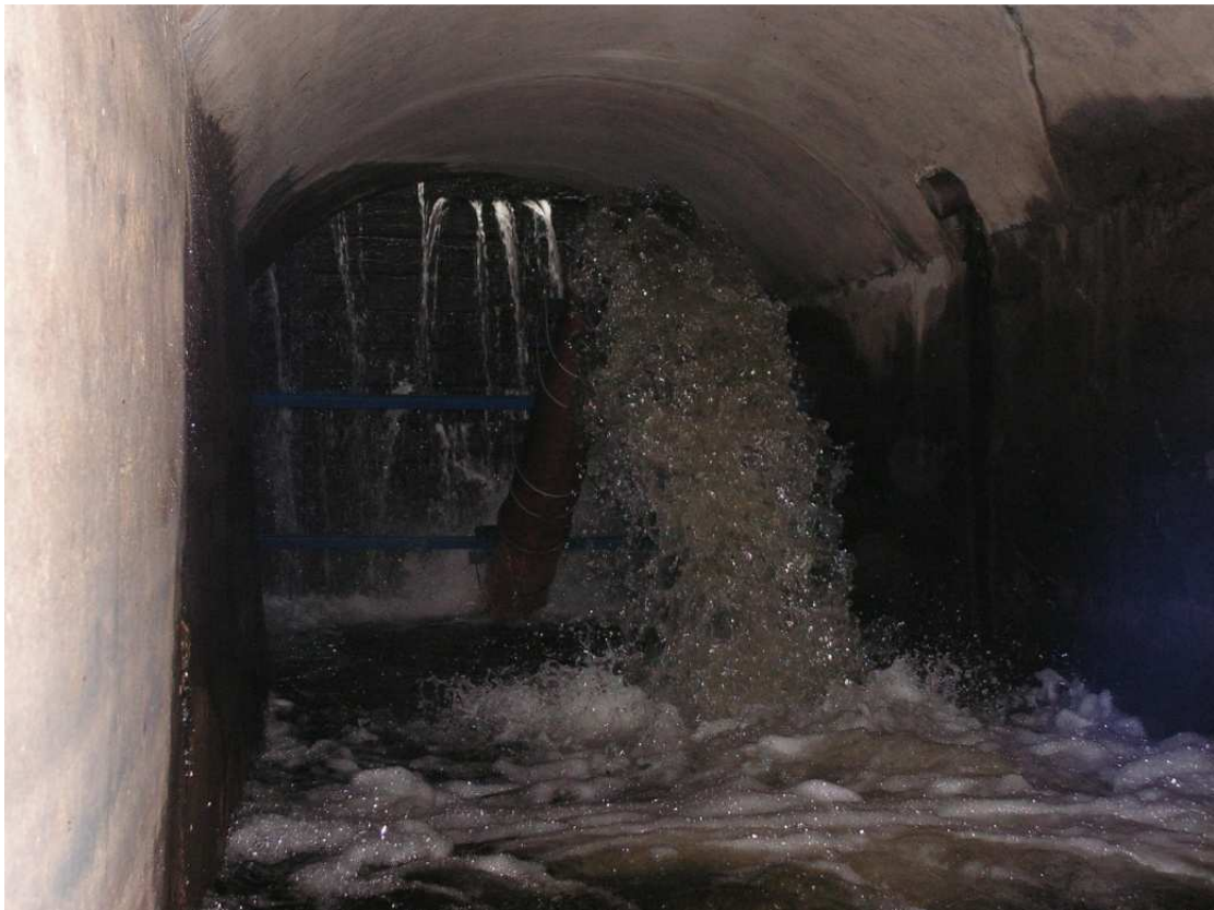
Foto 20: Bypass in Betrieb
